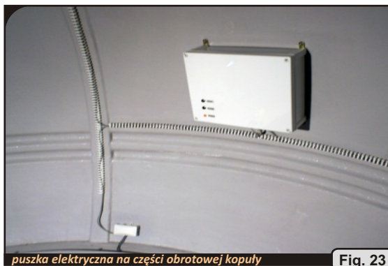
puszka elektryczna na części obrotowej kopuły
