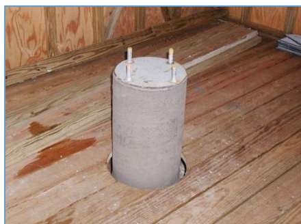
Fot. 60. Podłoga niezależna od słupa teleskopu
